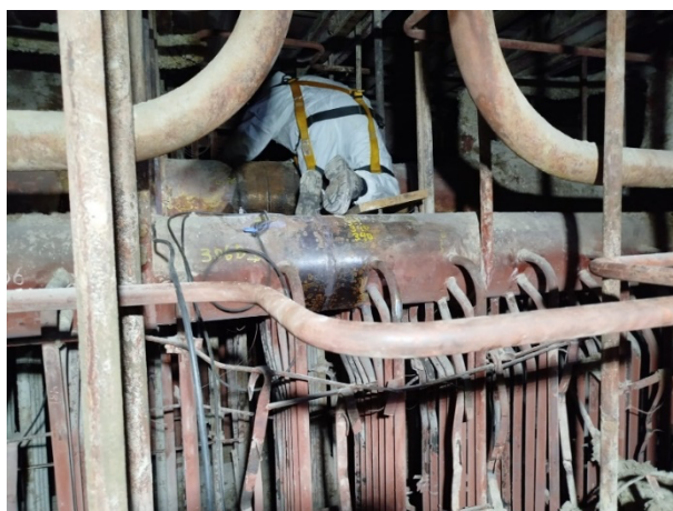
Figura 1 – Coletor de saída e serpentinas de vapor superaquecido da Unidade Geradora 5 – UTLB, abril/2025
