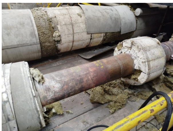
Figura 2 – Tubulação de vapor superaquecido da Unidade Geradora 5 – UTLB, abril/2025
